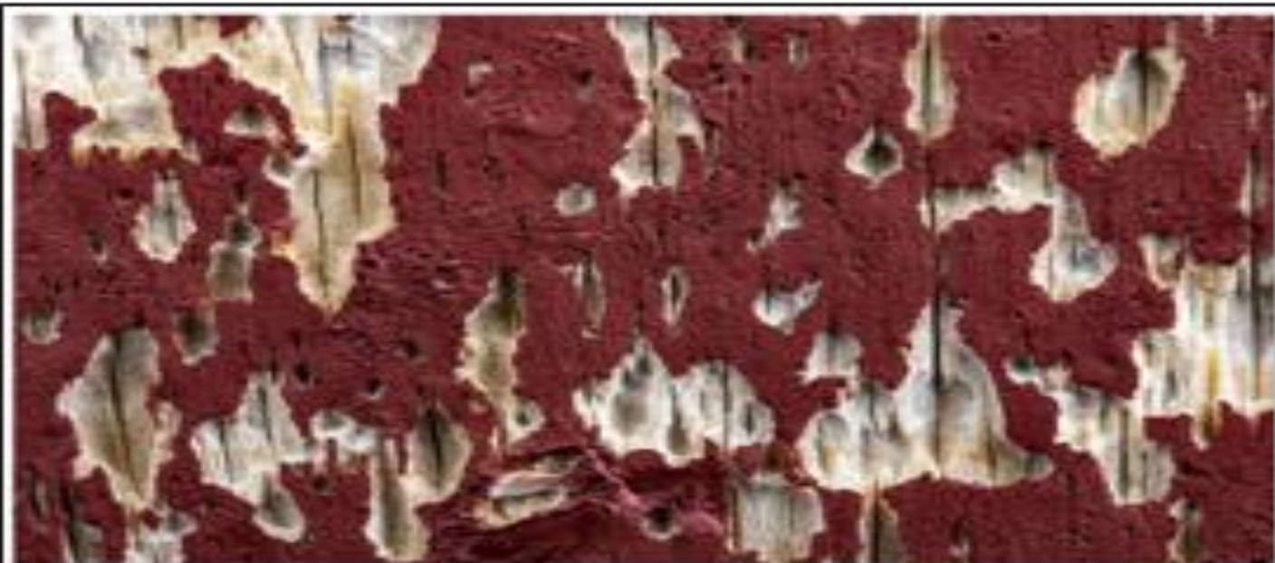
Fig 4-17. Skador på nordostvägg sannolikt genererat av smulsten som transporterats av vind.
