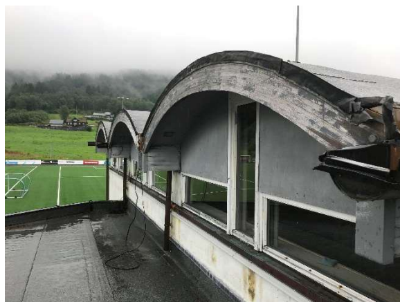
Limtrebuer utvendig i hver ende av buetaket på Bygg C. Slitasje og råte på utvendig del. Ikke inspisert på nært hold innvendig.
