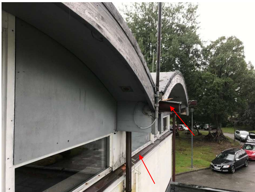
Figur 8. Kobber på fasade av Bygg C.
