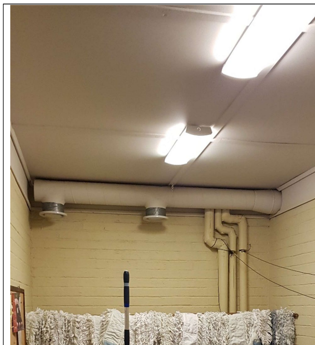
Bilde 2: Himlingsplater på rengjøringsrom med lister over plateskjøter.
