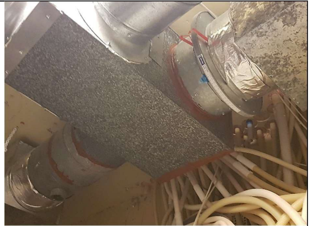
Bilde 7: Rødbrunt kitt på ventilasjonskanaler.
