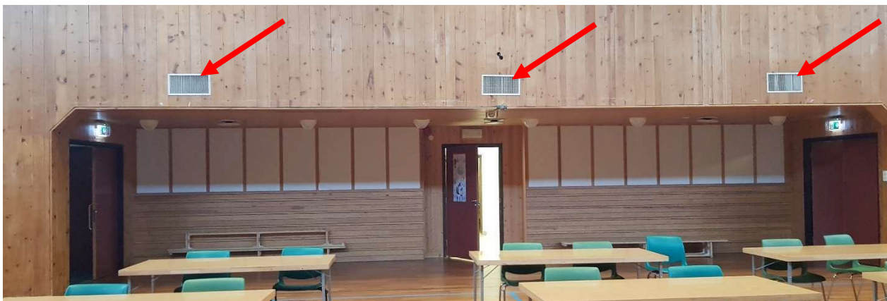
Bilde 2: Ventiler fra byggeår.
