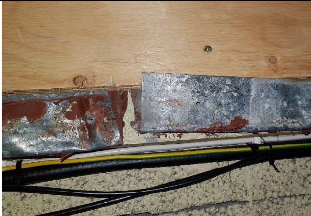
Bilde 6: Åpning for trapp i dekket på teknisk rom. Rødbrunt kitt på beslag. Mulig tidligere takoppbygg for ventilasjon?
