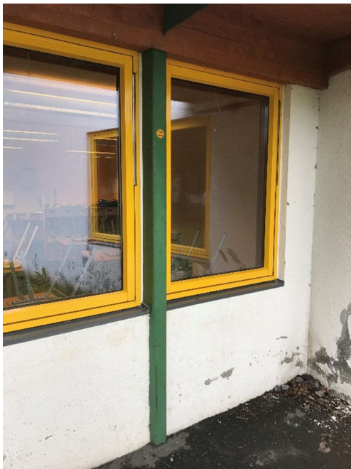
Figur 7: Stålsøyler og knekt fasade Bygg B.
