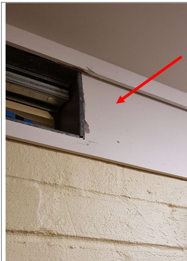
Bilde 4: Veggplater med krysotilasbest i topp av murvegg
