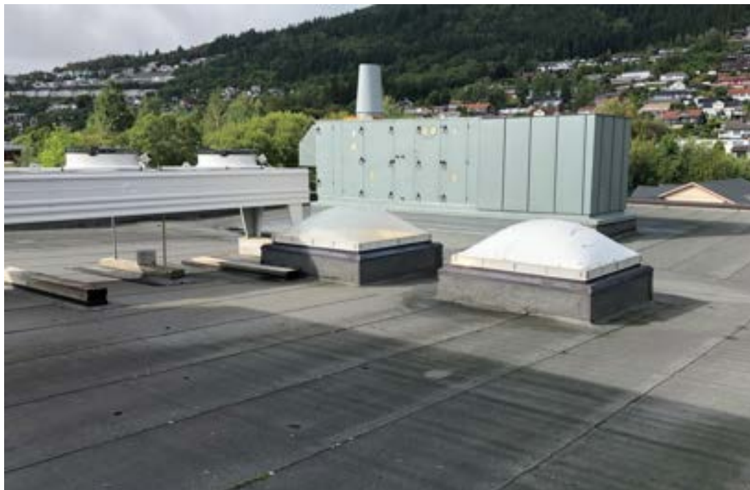
Figur 2.6.0. Bilde viser aggregat til høyre, tørrkjøler til venstre samt 2 stk. overlys som skal fjernes.
