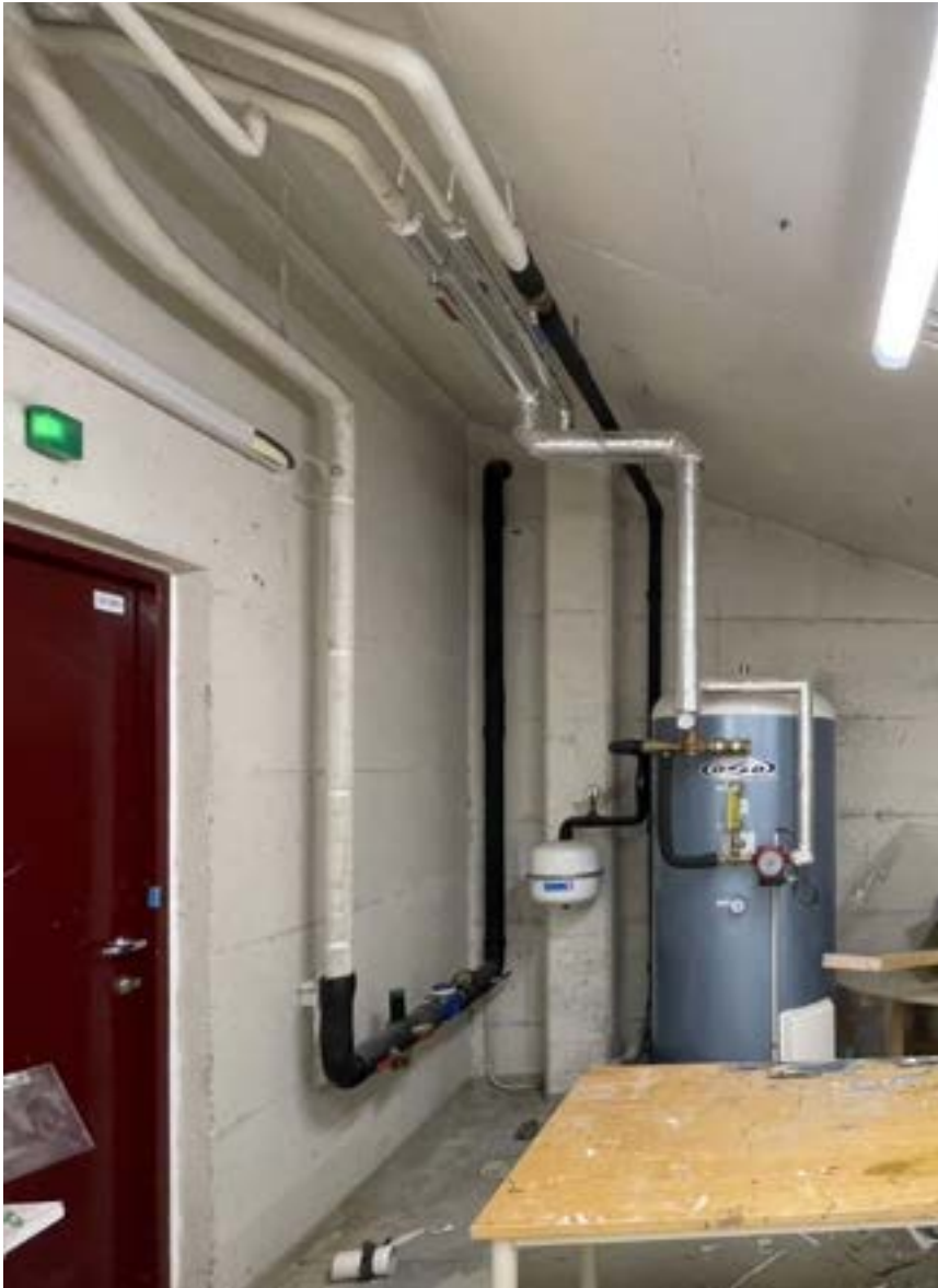
figur 3.1.0-2 Eksisterende plassering av vanninntak og bereder i varmesentral.
