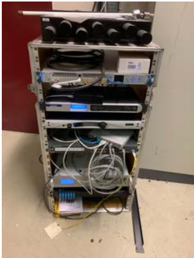
Figur 4.3.0-1 Antenne-rack på loft.
