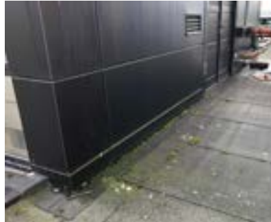
Figur 1.19.2-2. Teknisk rom på tak.
