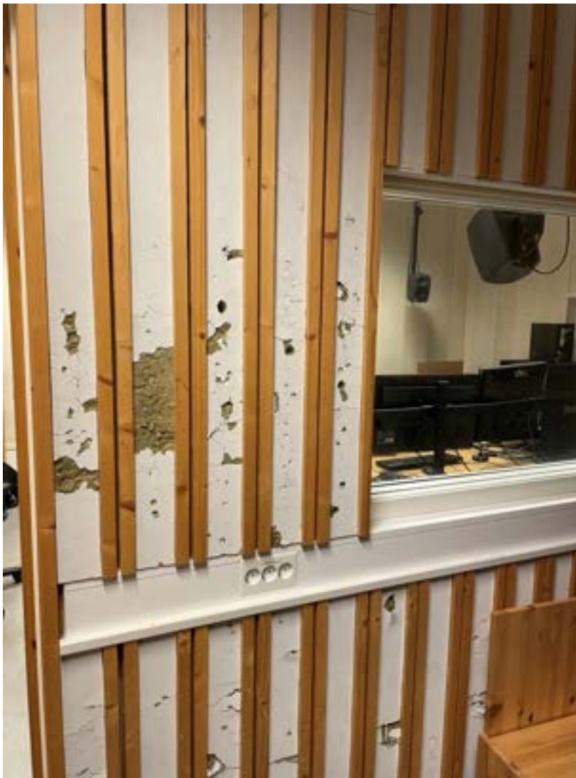
Figur 2.0.4-3. Rom HS-082 Skadet spilevegg.
