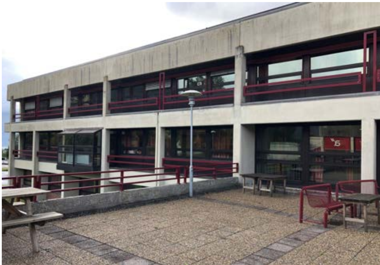
Figur 2.8.7-1. Rødt rekkverk på fasade øst.
