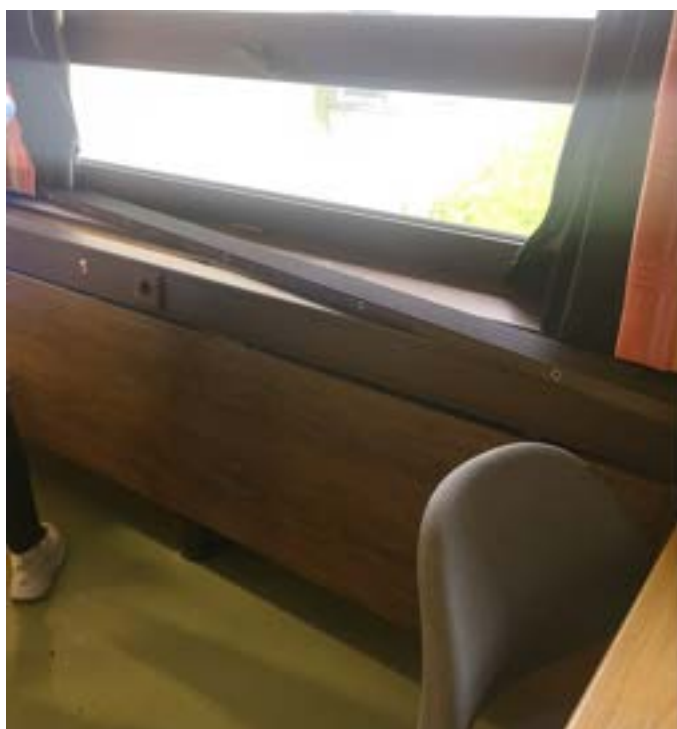
Figur 3.2.0-1: Innbygd kasse for oppvarming og tilluft.
